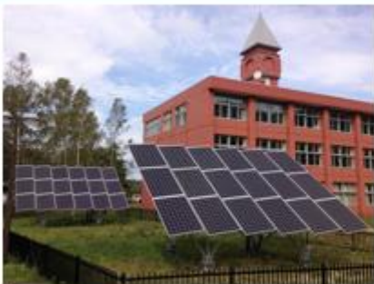
避難所に設置した太陽光発電
